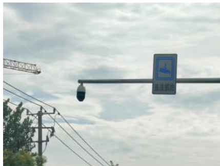
▲ 华丹路抓拍监控一期已安装
